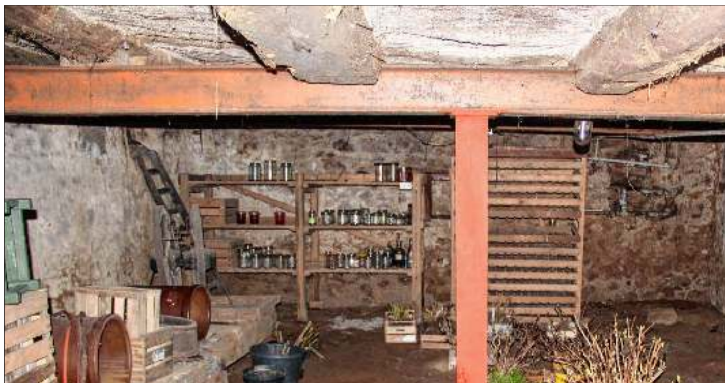
Blick in den Keller: Die beschädigten, durchhängenden Deckenbalken müssen dringend ersetzt werden.
