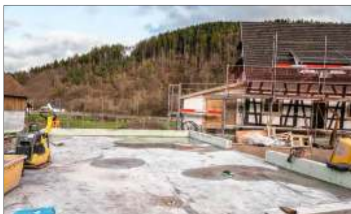
Mit dem Legen der Bodenplatte beginnt im September 2022 in Gutach der Bau des Nebengebäudes.
