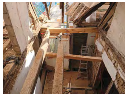
Abb. 7: Restaurierung der stark geschädigten Ecktraufe
